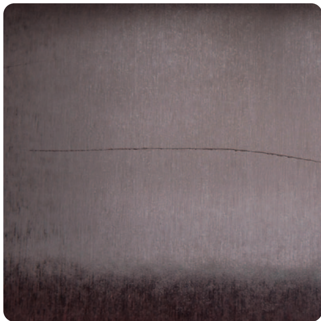
Царапина с повреждением облицовочного покрытия
